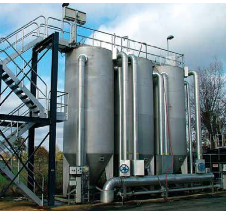
Instalacja filtrów DynaSand w oczyszczalni ścieków w Bree, Belgia.
