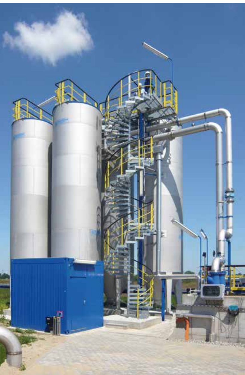
Redukcja azotu filtrami DynaSand Deni w zakładach Yara Brunsbüttel GmbH, Niemcy
