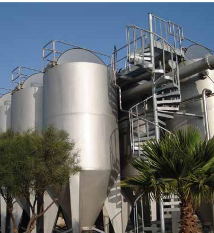
Typowa instalacja filtrów DynaSand DS5000 AD HD. Filtry wyposażone są w pokrywy i nie wymagają zadaszenia.
