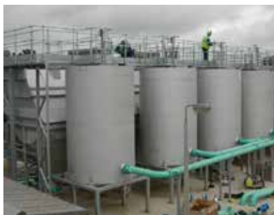
Instalacja osadników Lamella i sześciu zbiorników flokulacji o pojemności 19m 3 w Wielkiej Brytanii
